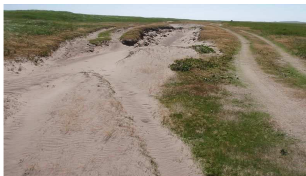
Photo n°42 : dégradation de la piste, 2010, SPM Frag'iles
