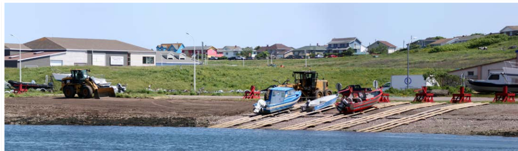
En plus de la VH, les équipes du district routier participent à plusieurs chantiers, comme ici le terrassement des abords du Barchois de Saint-Pierre avant la mise en place de nouveaux cabestans et échouages.
