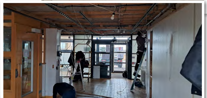
Trois chantiers : installation d'une borne de recharge pour voiture électrique sur le parking du siège, isolation phonique mur et portes à l'atelier diesel, réfection de l'accueil du siège.
