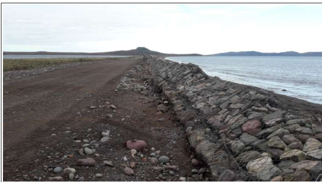
- Gabions affaissés du côté plage -
